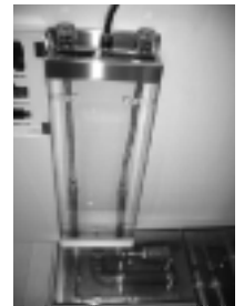
スケルトンで見ることができる排水管の配管状況
