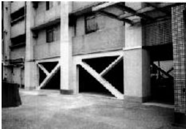
駐輪場とトランクルームとして使用しているピロティ部分を ブレースと耐震壁で補強した。落下防止用の庇も取付けた。
