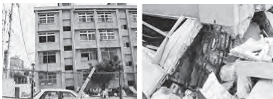
RC造・ラーメン構造の住棟5階建て 旧耐震基準のRC造ラーメン構造の住棟。(左写真)柱の耐力不足により、1階住戸部分が圧壊し死者が出てしまった。5階建てが4階建てになり、傾斜している。(右写真)1階部分の圧壊した部分の柱には、帯筋が飛んでしまったのか数本しか見受けられない。 資料：国土交通省「マンション耐震化マニュアル」(平成26年7月再改訂)
