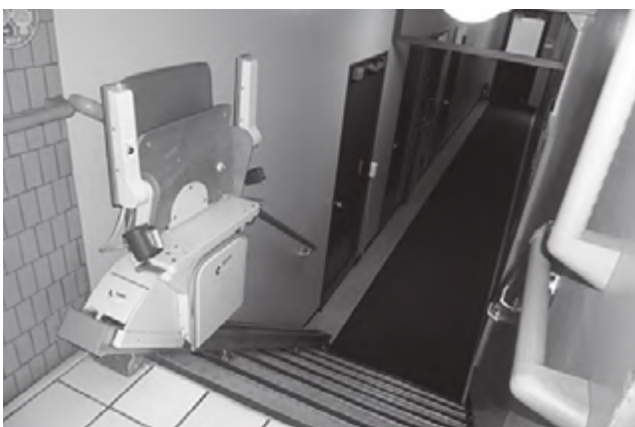
階段昇降機で、将来を見すえた安全対策
